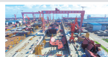
6月19日 公司大型邮轮总装建造项目重点工程——2号船坞接长改造项目与薄板加工中心厂房工程相继完工交付。
